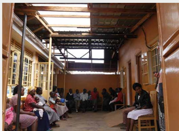
L'accueil a été couvert et rénové, et sert désormais de grande salle d'attente. Ceci permet de créer une 2 e salle de traitement à l'intérieur.
